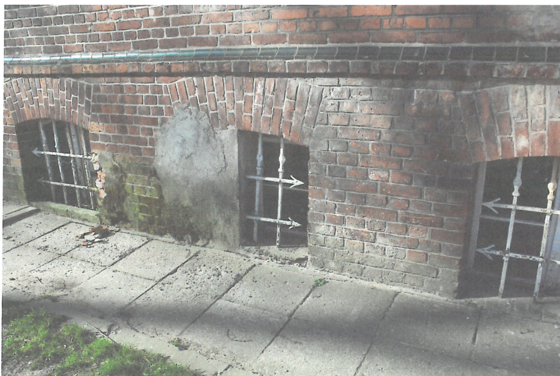
Fot.3– Zamurowana część okna piwnicy, fragment kraty do odtworzenia
