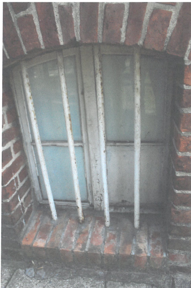
Fot.5– Okno piwnicy, krata do odtworzenia na właściwy wzór
