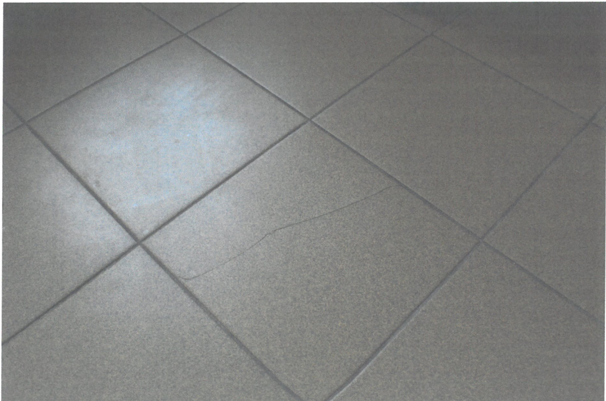
Fot.12– Uszkodzenia płytek
